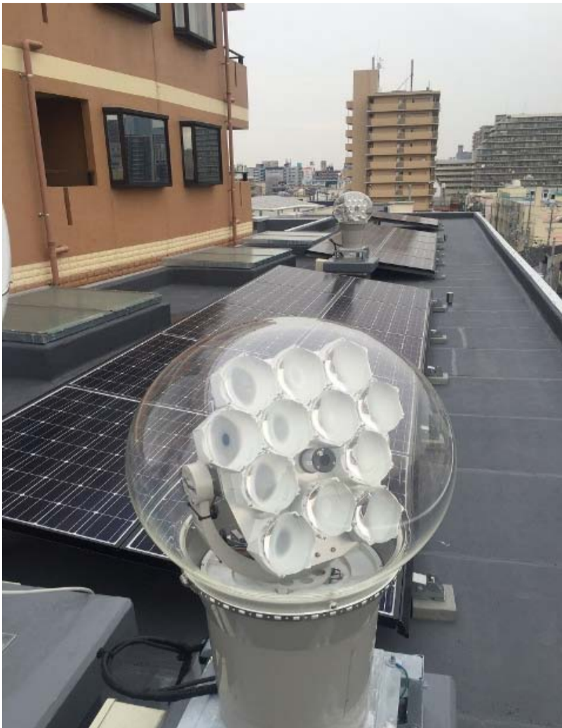
【屋上:ASレンズ式集光機】
