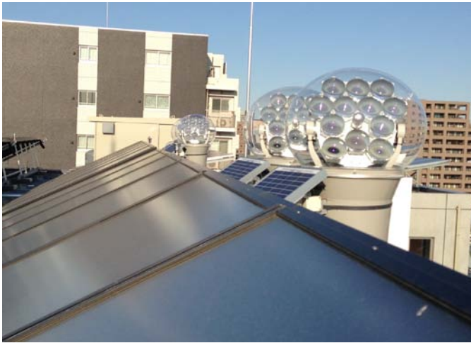
【屋上:太陽電池駆動型集光機】
