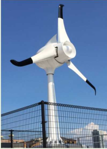
屋上に小型風力発電設備を設置 (東京都品川区立御殿山小学校)
